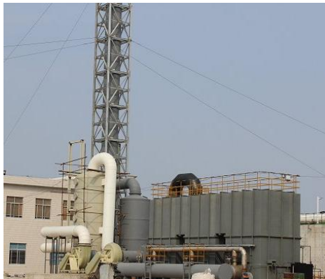
已经投入运营的 RTO 尾气焚烧炉
